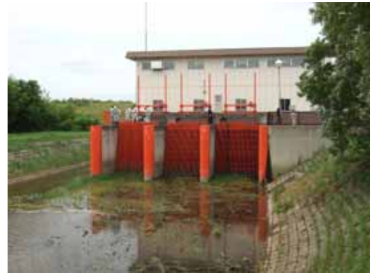
12 取水口の草の繁茂
