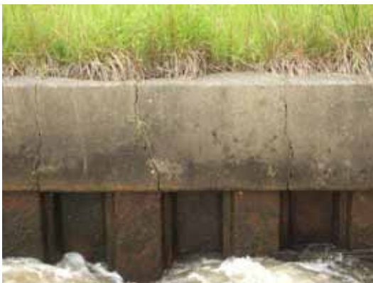
25 右岸矢板護岸天端コンクリートクラック
