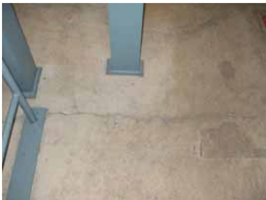
5 床コンクリートクラック
