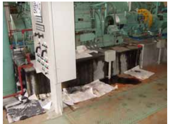
16 原動機のオイル漏れ
