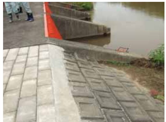
6 取水口上流護岸ブロックの沈下
