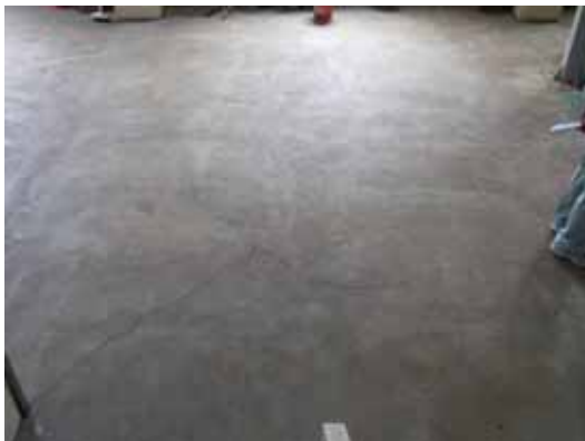
15 床コンクリートクラック
