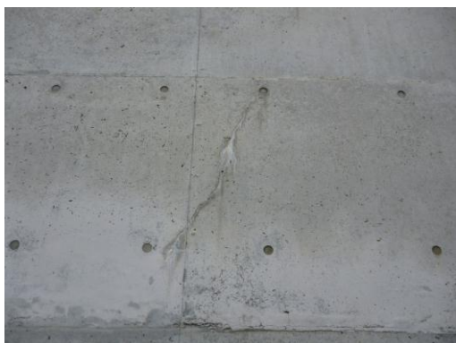
【北生振揚水機場（吐水槽）写真】
