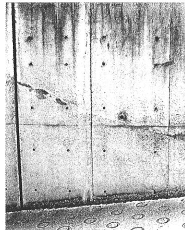
写真 2.2.2-1 コールドジョイント
