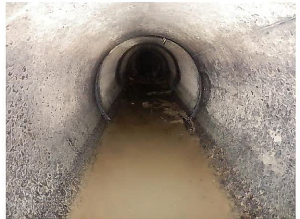
呑口部の管内※継目のズレが見られる
