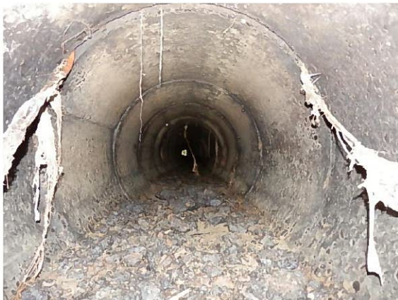
開口部から上流※継目から植物根混入
