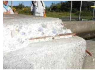
⑭ sp3270 町道横断（逆サイフォン）コンクリートの破損による骨材の露出
