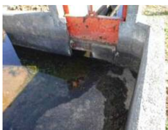
㉑ sp4030 分水門の錆
