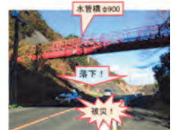
耐震性能が不足する施設
